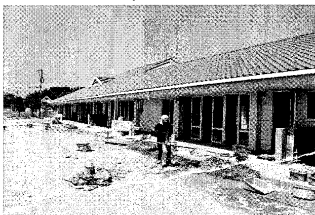
土砂の撤去作業が続く、まきびの里保育園
