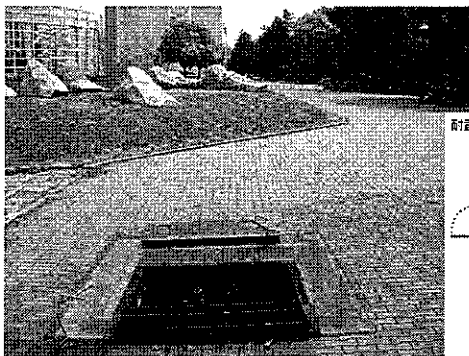
飲料水兼用耐震性貯水槽
